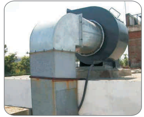
SISW FAN KITCHEN EXHAUST
